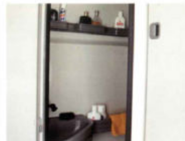
GIK-Naßzelle mit Waschbecken und Dusche
